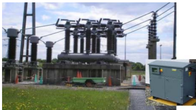
Рис. 14. Национальная энергетическая система Великобритании, подстанция в Кэпенхерсте
