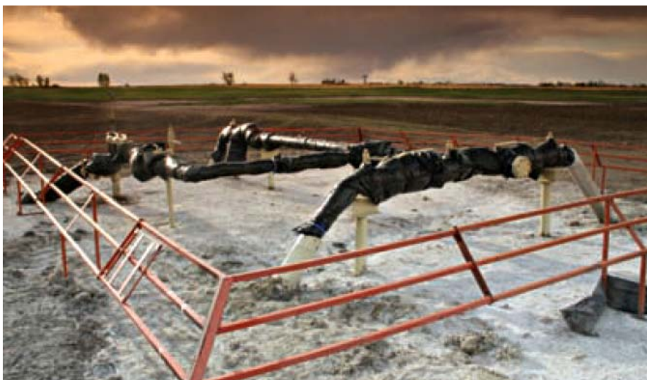
Рис. 1. Неглубокие газовые скважины в Юго-Восточной части провинции Альберта
